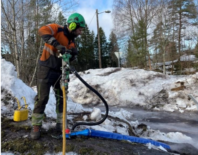
Bilde til venstre: Vertikalboring med Montabert T18 med dempehåndtak, uten vektlodd (gult lodd i bakgrunnen)
